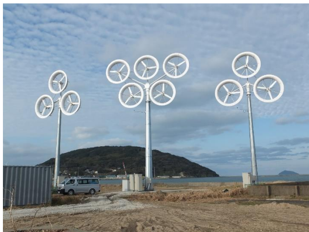
(左：9kW / 中央：15kW / 右：9kW)
